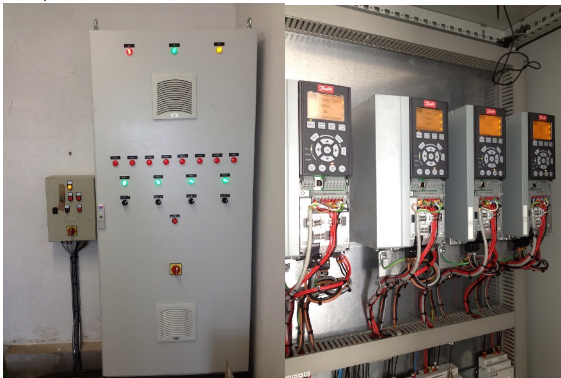
Figura 3: lado esquerdo: aspecto geral do Quadro 1. Lado direito: variadores de corrente instalados no quadro 1, para serviço do Furo 3, Furo 4, Furo 5 e Furo 2.
